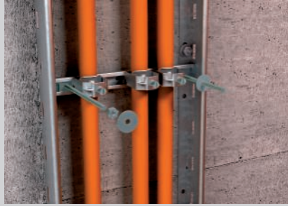
Befestigung in den Sprossen von Steigleitern.
