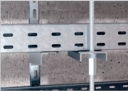
Gewindestangenbefestigung an der Kabelrinne bei mehrlagiger Anordnung.
